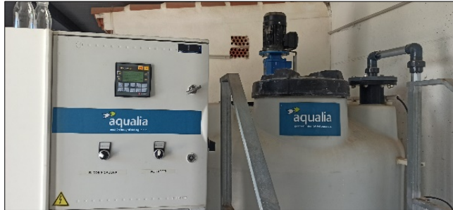
Figura 35. Depósito y control de tratamiento desincrustante.
