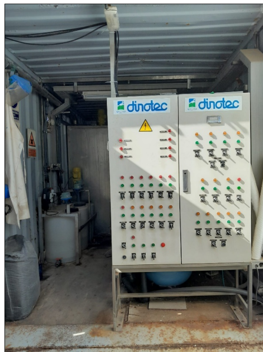
Figura 16. Cuadro de control ETAP Sierra Grande.
