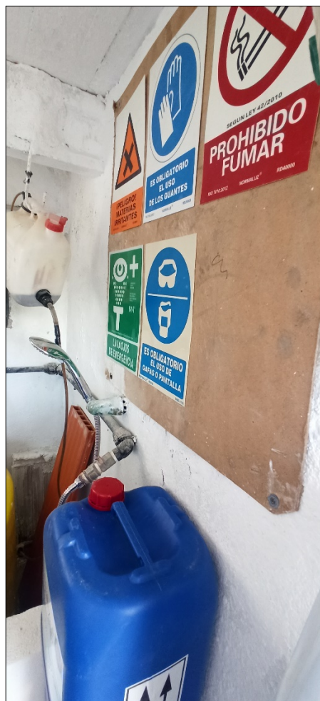
Figura 13. Grifo de seguridad y señalización de la caseta de cloración del sondeo La Maleza.
