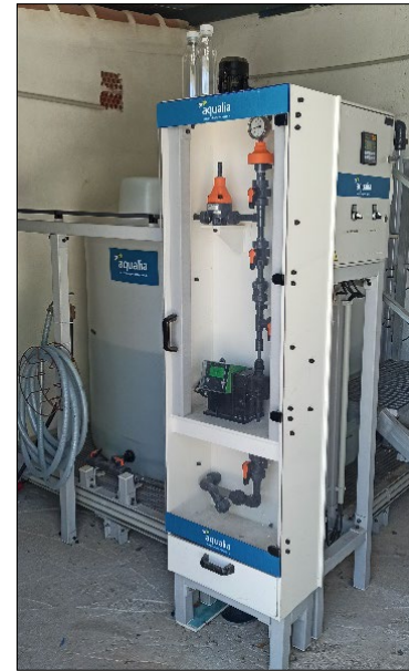
Figura 36. Válvulas del tratamiento desincrustante
