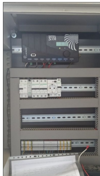
Figura 30. Estación remota de telecontrol.
