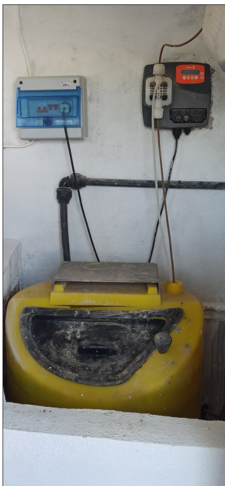
Figura 12. Bomba de cloración del sondeo La Maleza.
