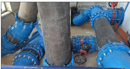
Figura 27. Sala de valvulas depósito nuevo El Calvario
