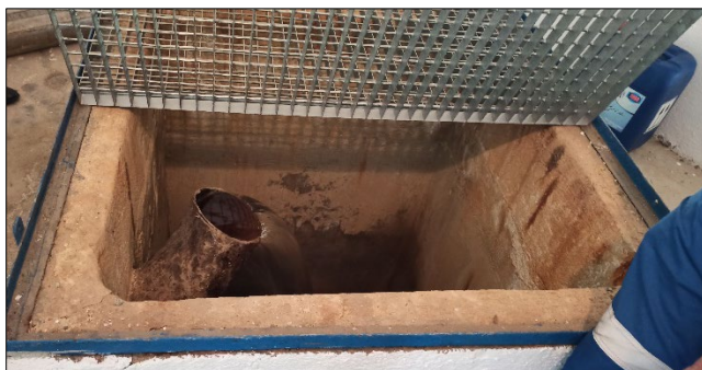
Figura 8. Tubería que funciona por gravedad del sondeo La Maleza.
