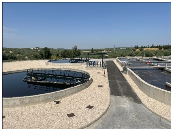
Figura 49. Decantador secundario y tratamiento biológico de la EDAR de Martos.
