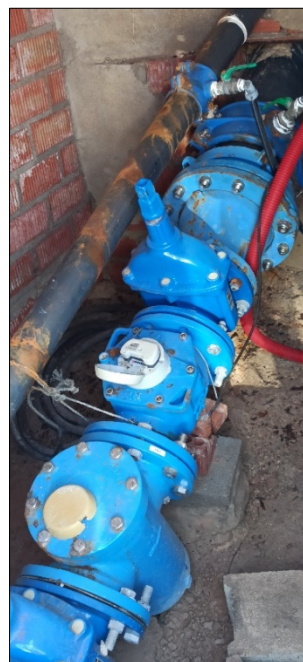
Figura 38. Contador de entrada al depósito El Portillo.
