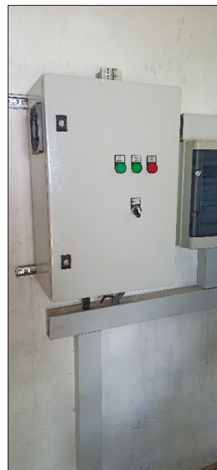
Figura 7. Cuadro de control de bomba.
