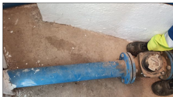
Figura 9. Tubería del grupo de bombeo del sondeo La Maleza.
