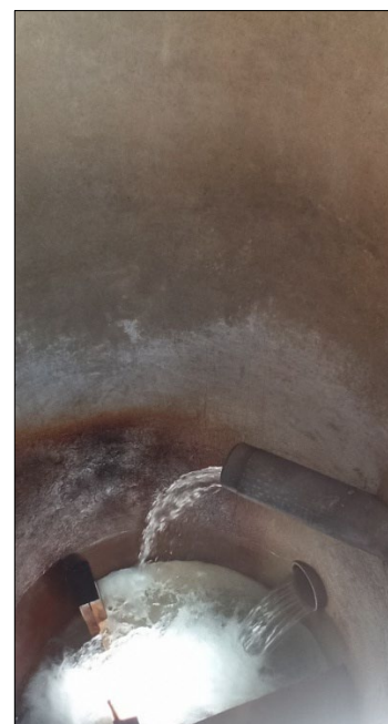
Figura 19. Interior de arqueta de unión de manantial y sondeo La Maleza.
